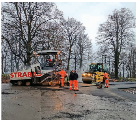
Asfaltový povrch pokládaly na nové cestě k poutním domům stroje stavební firmy ve dnech 21.–22. listopadu 2022. Foto: P. Ladislav Nosek SJ
