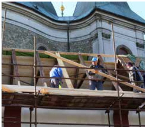
Během obnovy musely být vyměněny trámy střechy kaple. Foto: P. Ladislav Nosek SJ
